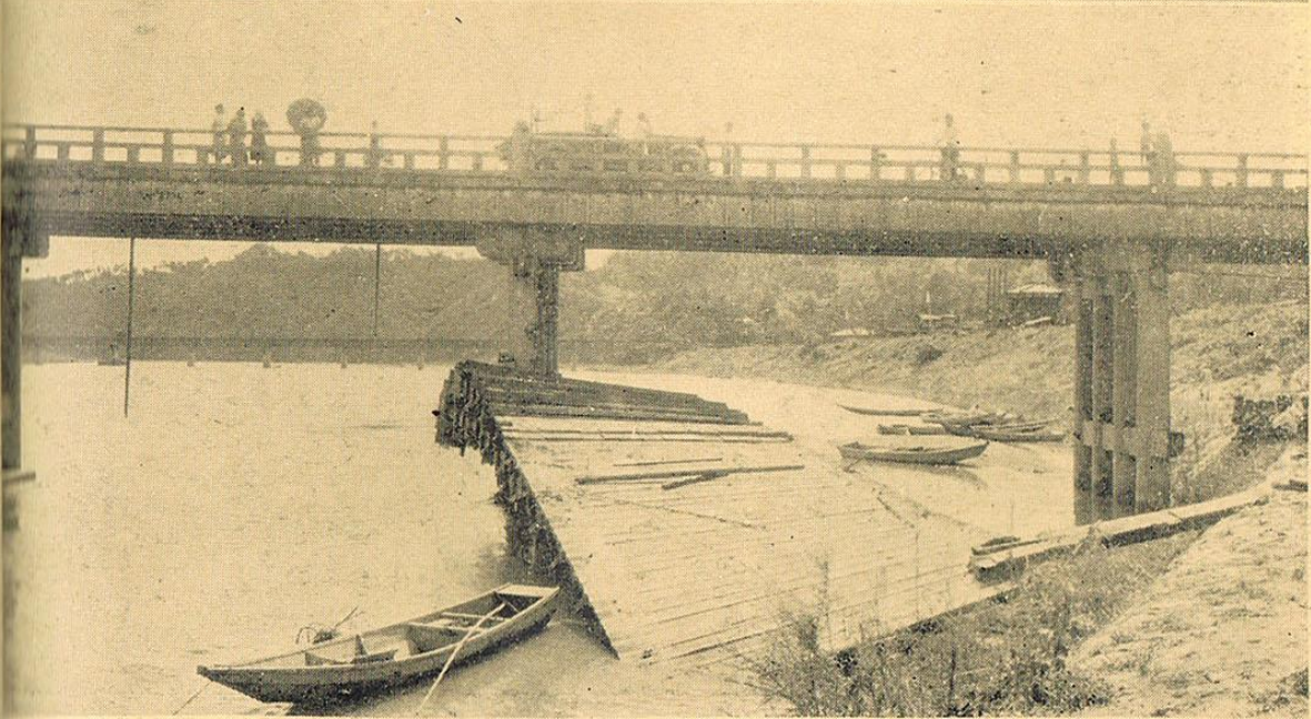
流失の橋材、下流の橋脚に引つかゝつて 残骸をさらす
